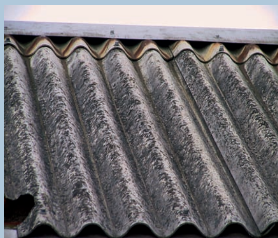
Bild 10 Oberflächlich verwitterte Asbestzementwellplatten [C.1]
