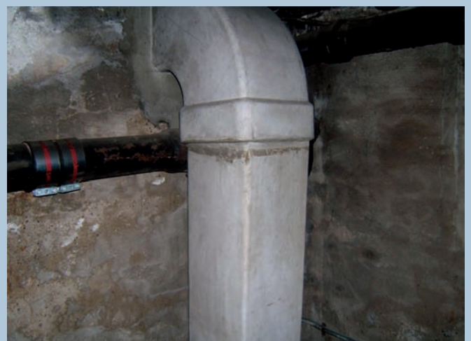
Bild 3 Luftschacht aus Asbestzement [C.2]
