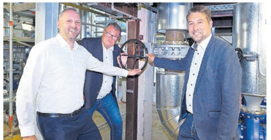
Stadtwerke Netz-Vorstand Thomas Gebhart, Energie SaarLorLux-Vorstand Joachim Morsch und Oberbürgermeister Uwe Conradt (v. l.) bei der Einweihung der neuen Fernwärmeverbindung. Foto: SW/Iris Maurer
