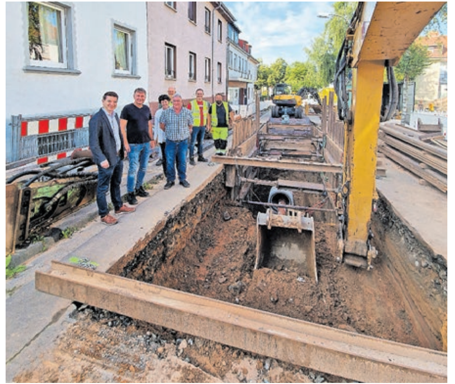
Baudezernent Patrick Berberich (vorne) hat sich den Baufortschritt auf der ZKE-Baustelle „Am Homburg“ angeschaut.
