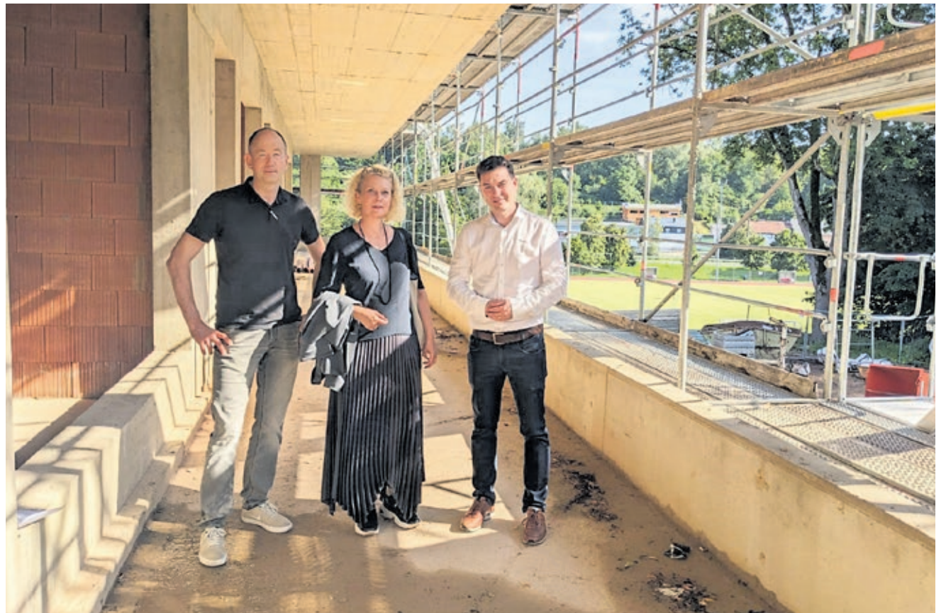
Markus Hollenbach von GMS, Bildungsdezernentin Sabine Dengel und Baudezernent Patrick Berberich (v.l.n.r.) bei der Baustellenbesichtigung der Kita Lindengarten in Dudweiler. Foto: GMS
