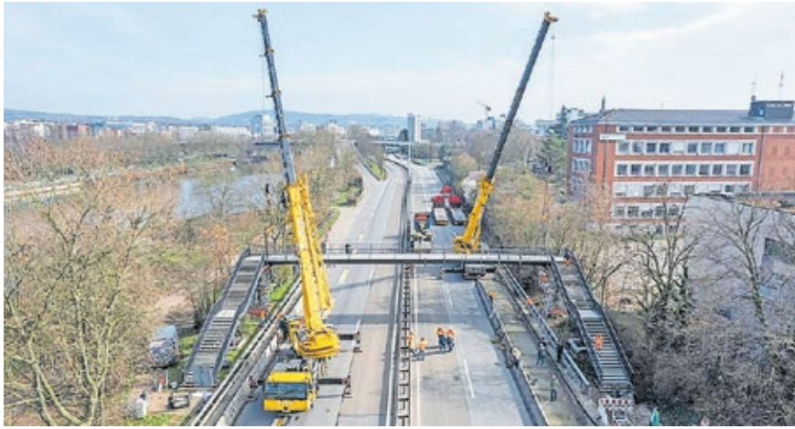
Die Werderbrücke wurde Anfang März wieder in Saarbrücken über der A620 montiert. Foto: SBS-Ingenieure
